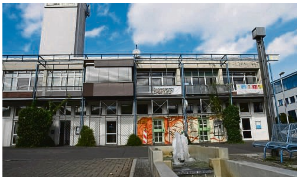
Sanierung dringend nötig: Die alte Feuerwache muss vor einer neuen Nutzung ausgerechnet in Sachen Brandschutz ertüchtigt werden. FOTO: MICHAEL LÖW
